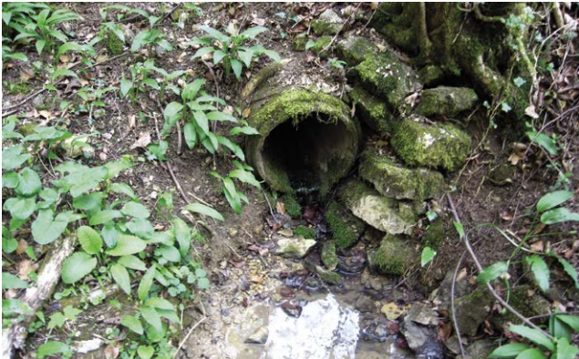
Abbildung 3.2 Stark geschädigter Quell-Lebensraum: Verrohrter Grundwasseraustritt
